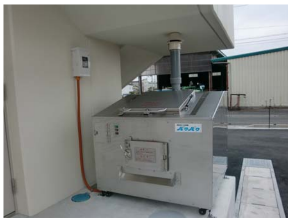
■1 槽式 50kg 処理／日(平成 25 年 3 月導入)
