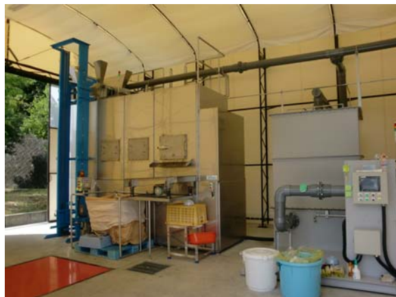
■2 槽式 1000kg 処理／日(平成 22 年 9 月導入)
