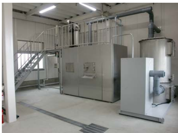
■2 槽式 200kg 処理／日(平成 24 年 1 月導入)
